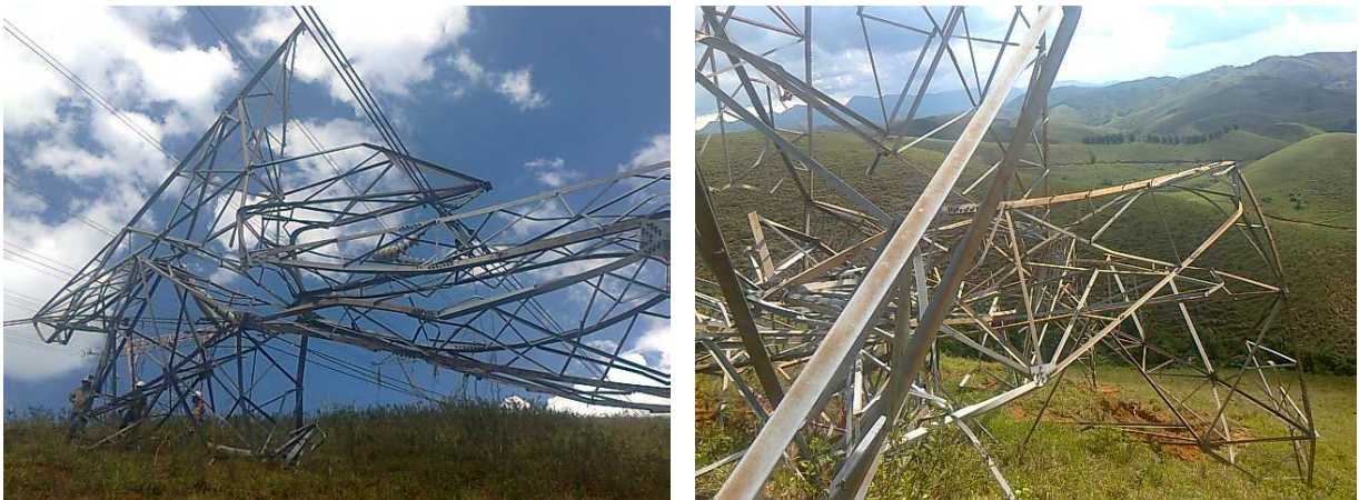
Figura 2: Torre de linha de transmissão em colapso
