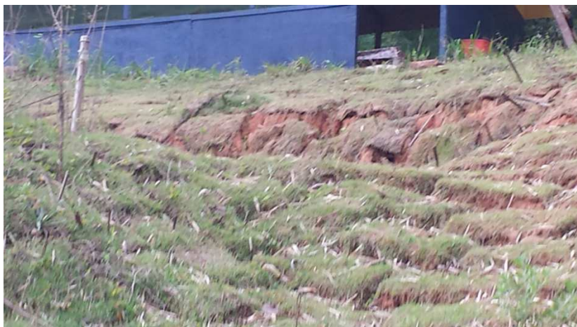
Figura 37 – Cicatriz desenvolvida cortina, devido à movimentação
