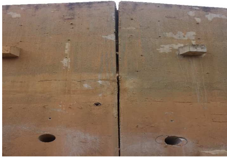
Figura 33 – Espaçamento entre os painéis da cortina devido à movimentação
