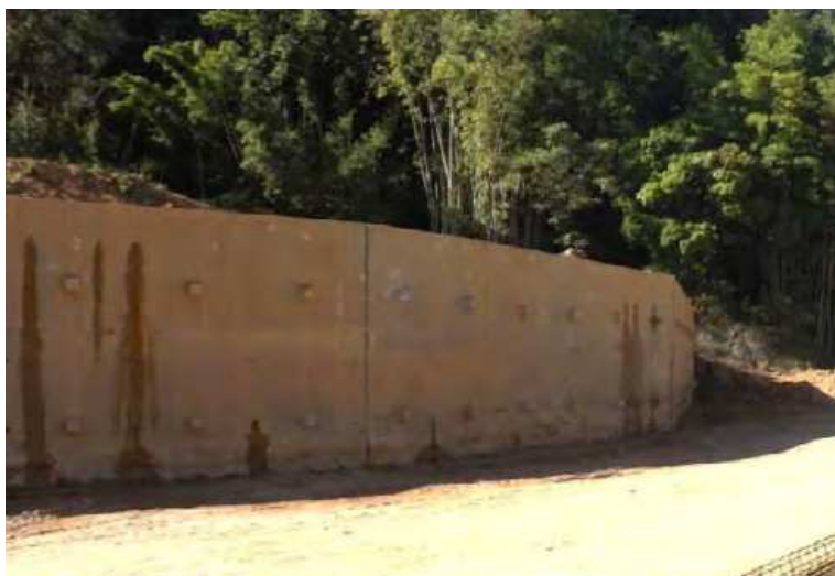
Figura 32 - Vista frontal da cortina atirantada, presença de água nos drenos
