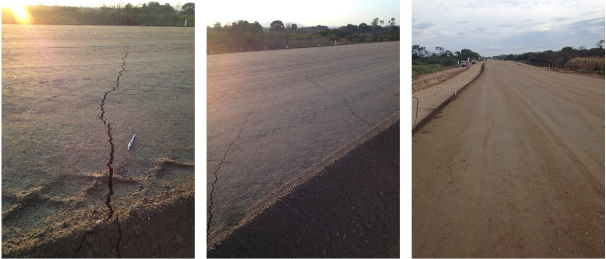
Figura 36 - Trincas ocorridas devido ao início de ruptura
