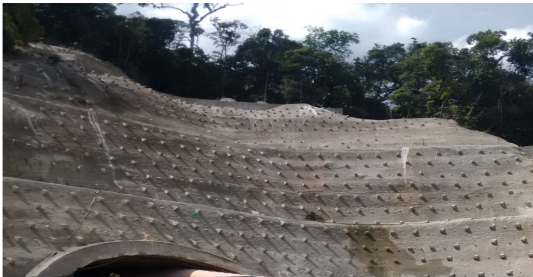
Figura 15 – Face em concreto projetado (arquivo pessoal 2015) – Nova Subida da Serra de Petropolis
