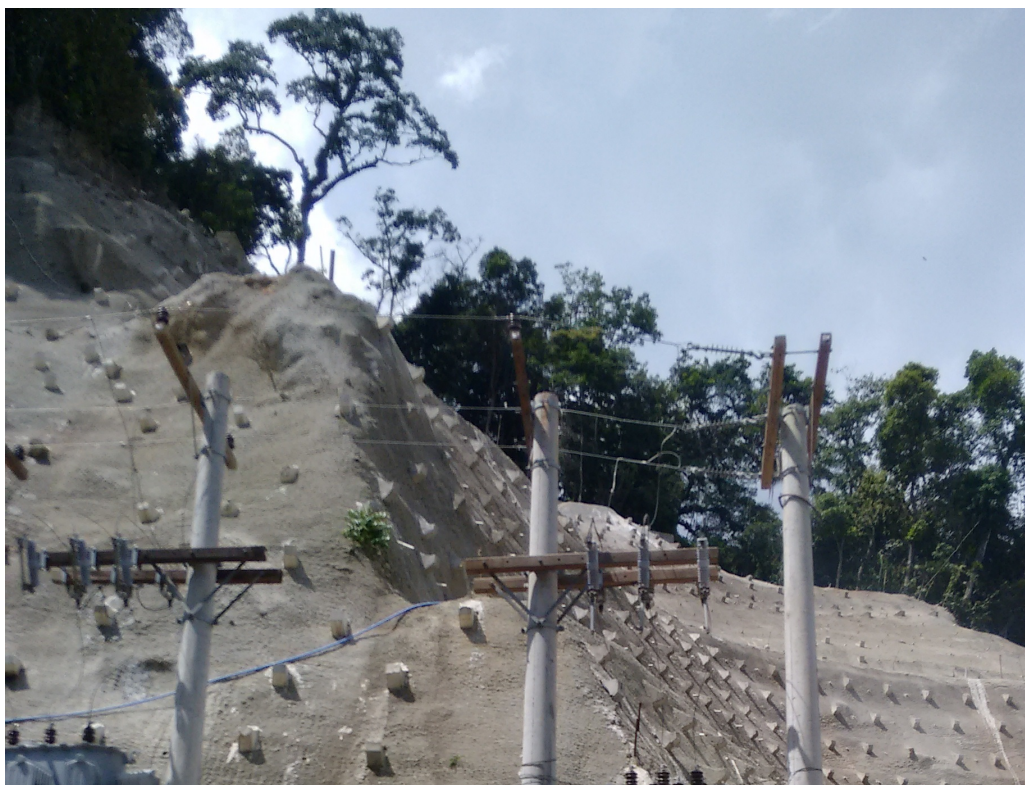
Figura 13 - Concreto Projetado - combinação de talude natural e escavado – Desemboque do novo túnel da nova subida de Petrópolis (arquivo pessoal 2015)
