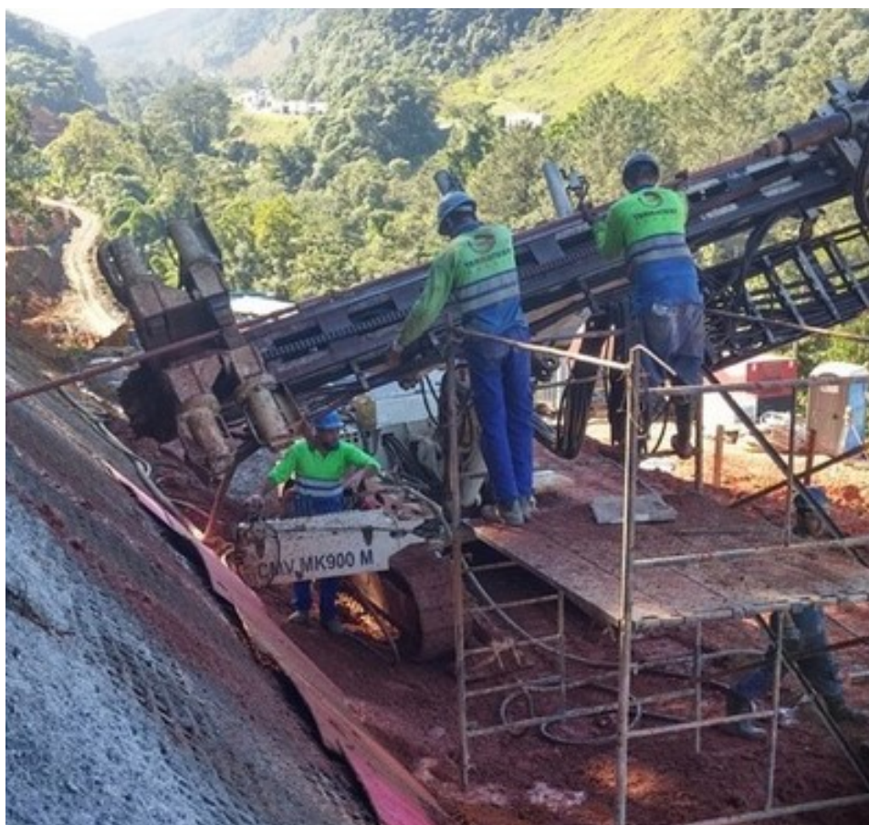
Figura 8 – Perfuração para execução de solo grampeado. Obra: Duplicação da Serra do Cafezal, Rodovia Regis Bittencourt, km 353
