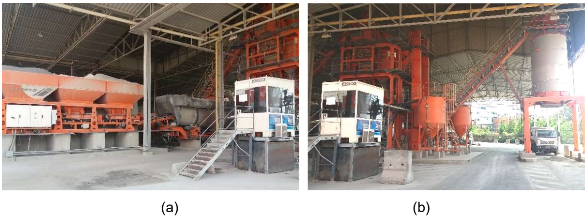
Figura 11 – Usina de reciclagem no Caju. (a) Silo dos agregados e cabine de operação; (b) Cabine de operação, silo de estocagem e descarga da massa
