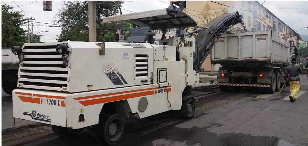
Figura 6 - Fresagem a frio com carga direta (Local: Rua Santo Evaldo em Padre Miguel no Rio de Janeiro)
