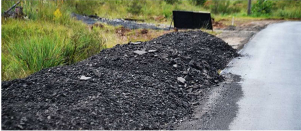
Figura 9 - Disposição inadequada de 12 mil m 3 em São Joaquim – SC (Disponível em http://saojoaquimonline.com.br acessado em 9/12/2016)
