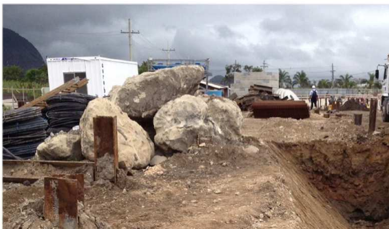
Figura 54 - Fotos da exumação dos bulbos formados no interior da camada (Sandoval, 2016)
