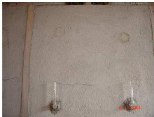
Figura 13 - Teste de permeabilidade em alvenaria
