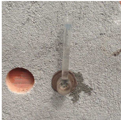
Figura 54 Cachimbo com vazamento de água superficial
