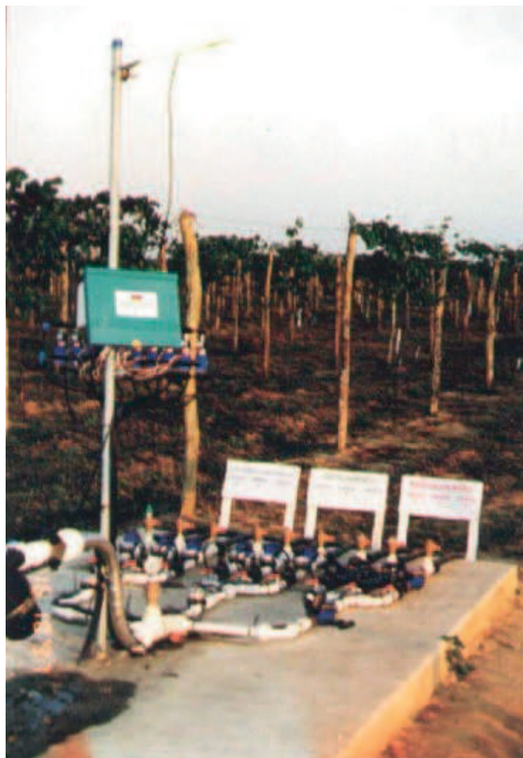
Figura 9 - Foto da Vista de frente do cabeçal de controle do equipamento. Extraído de (NOGUEIRA et al., 2001, Figura 14)
