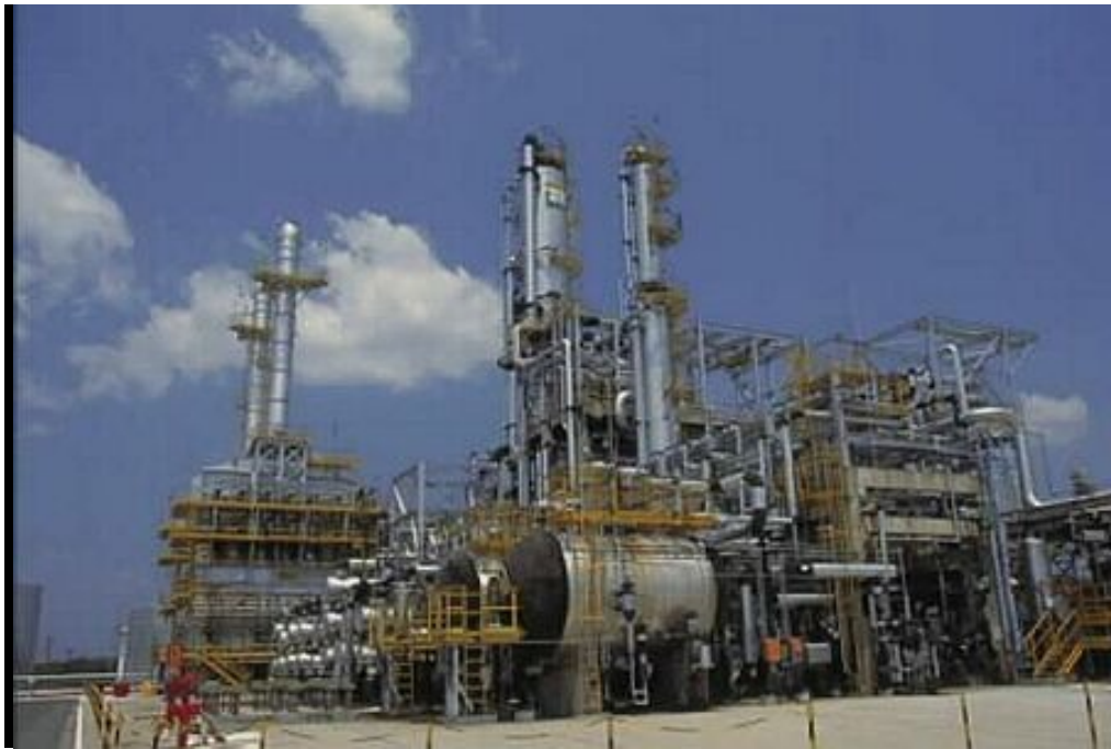
Figura 2 – Unidade de Destilação Atmosférica da REMAN (U-2111)
