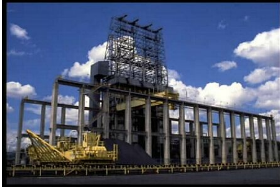
Figura 11 - Unidade de Coqueamento Retardado REGAP
