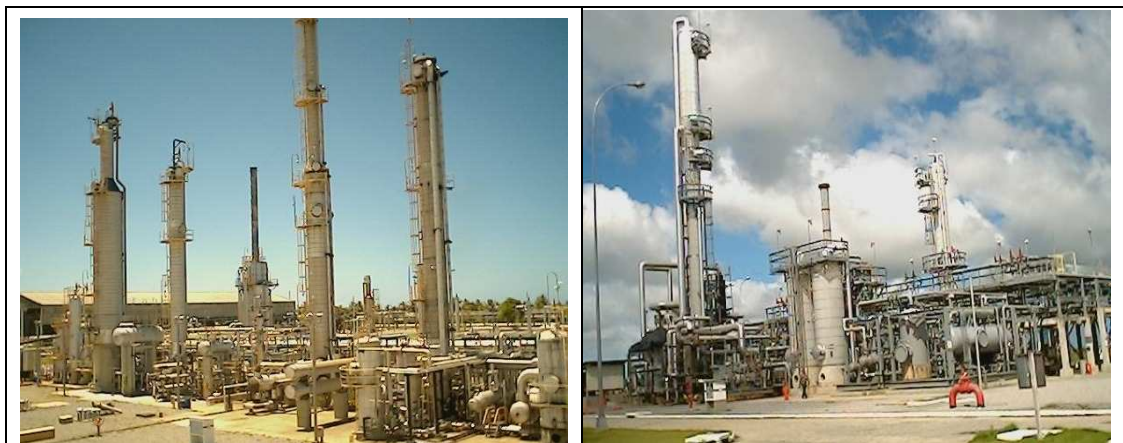
Figura 32 – UPGN de Atalaia-SE - processo Absorção Refrigerada.
