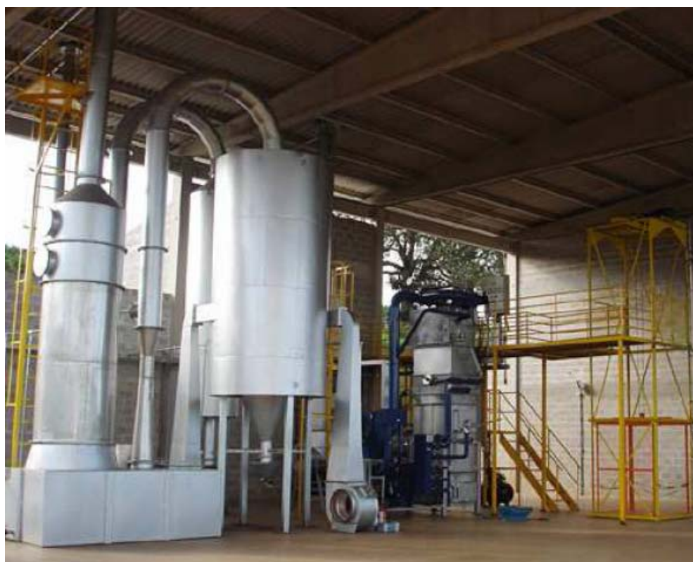
Figura 15 – Exemplo de incinerador instalado pelo fabricante consultado
