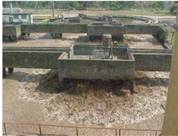
Figura 10 - Tanques de Aeração
