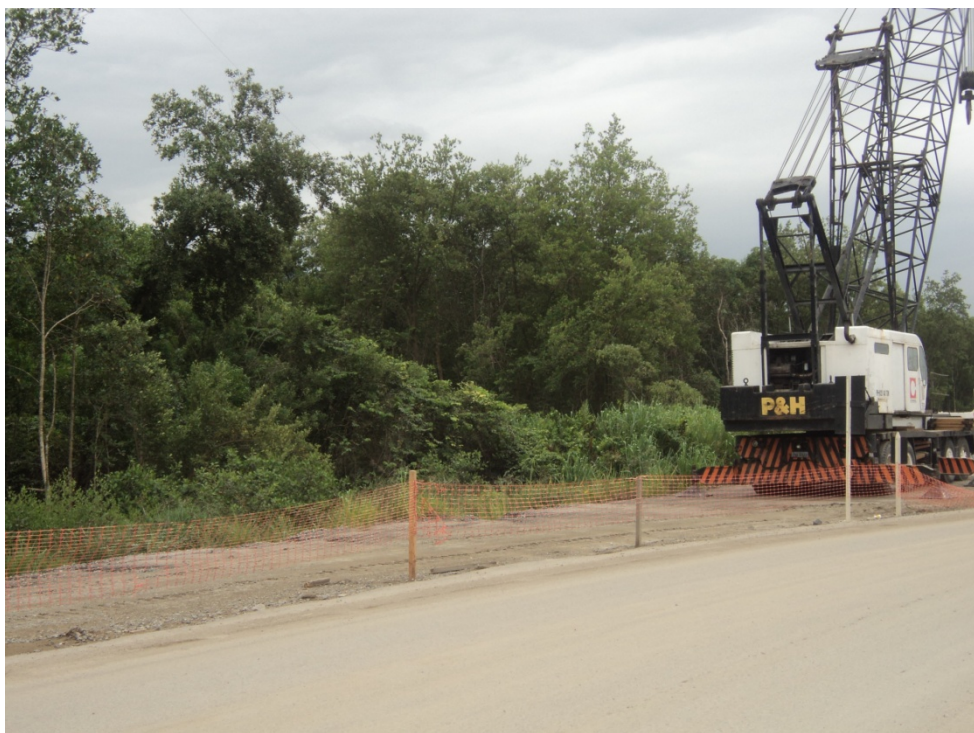
Figura 29 - Redução da área de manguezal para construção da linha férrea que atende o Porto Sudeste
