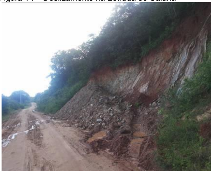
Figura 14 – Deslizamento na Estrada de Caiana
