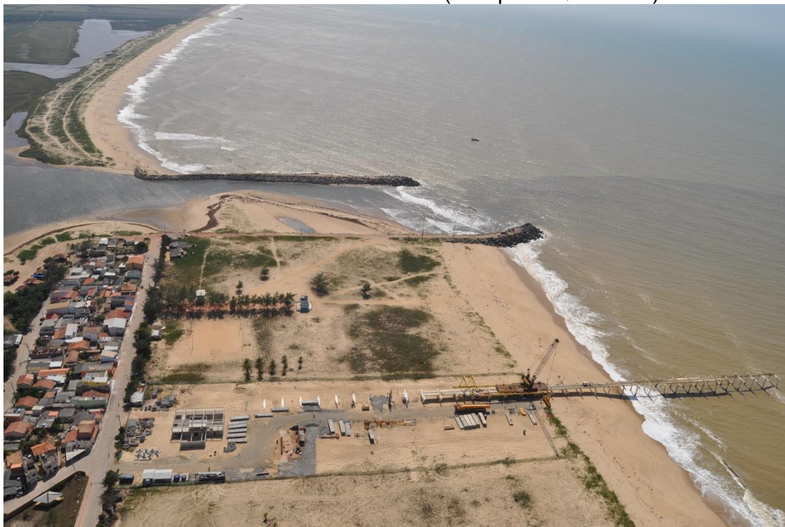
Foto do autor em sobrevoo 13 mar. 2013. Mostra obras iniciais e estaqueamento para o terminal cuja implantação foi depois interrompida.
