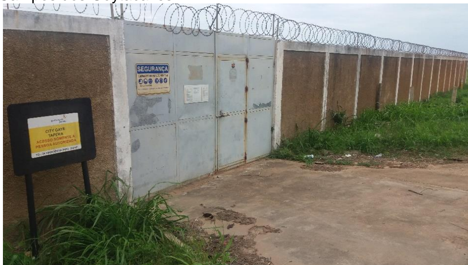
Foto 30 - City Gate da Tapera, da Gas Natural Fenosa (ex-CEG) em Campos dos Goytacazes.
