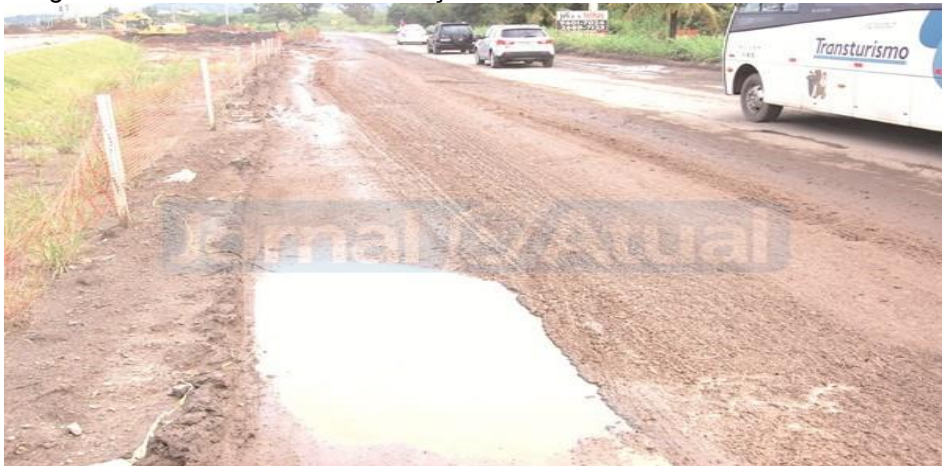
Imagem 9 – Problemas de conservação da estrada em Ilha da Madeira
