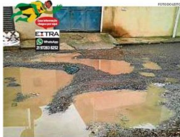
A água fica acumulada em buracos na Rua Santa Helena
