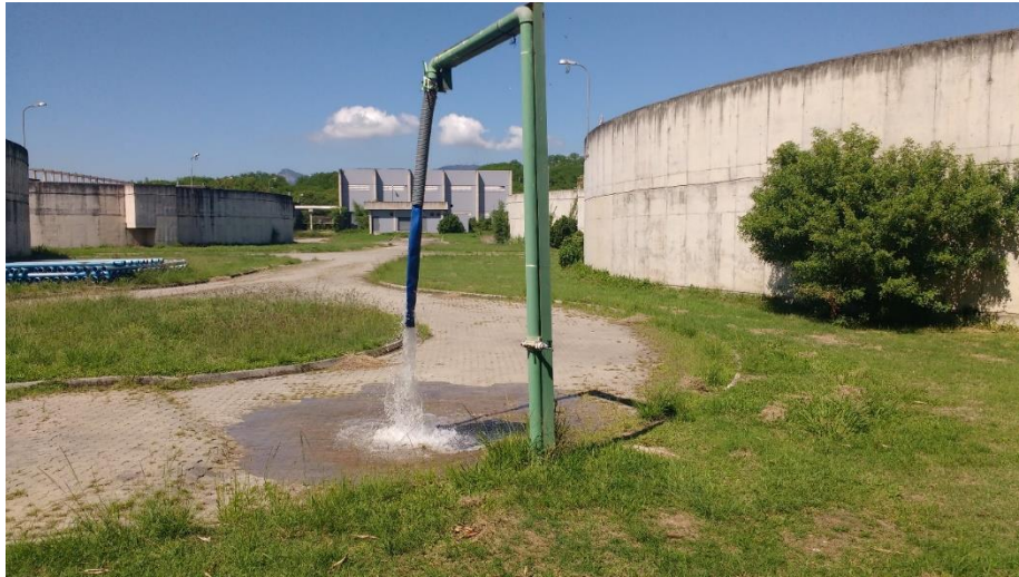
Figura 20 – Sistema de abastecimento dos caminhões pipa com água de reúso da ETE Alegria.
