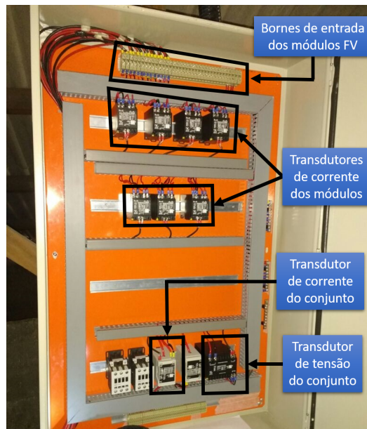
Figura 14: - Quadro Elétrico do Sistema Fotovoltaico.
