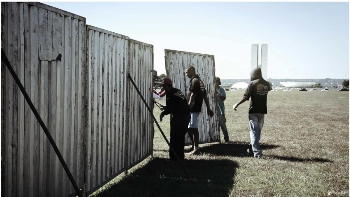
Legenda: Cenas do muro sendo colocado na Esplanada dos Ministérios Fonte: O Muro (Reprodução)
