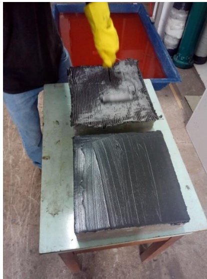
Figura 51 - Laminação da fibra de carbono utilizando resina Pipe Fix e rolete “tira bolhas”.
