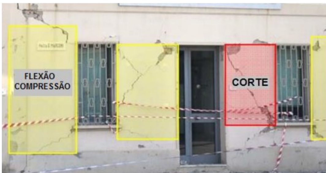
Figura 5 – Fissuras que ocorreram num edifício de alvenaria de tijolo, após um sismo ocorrido no norte de Itália, 2012. (Ferreira, 2014).
