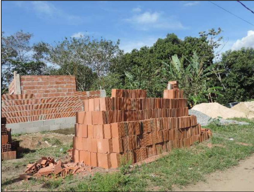
Figura 9 - Construção de uma nova moradia no entorno do PEM em Campo Grande
