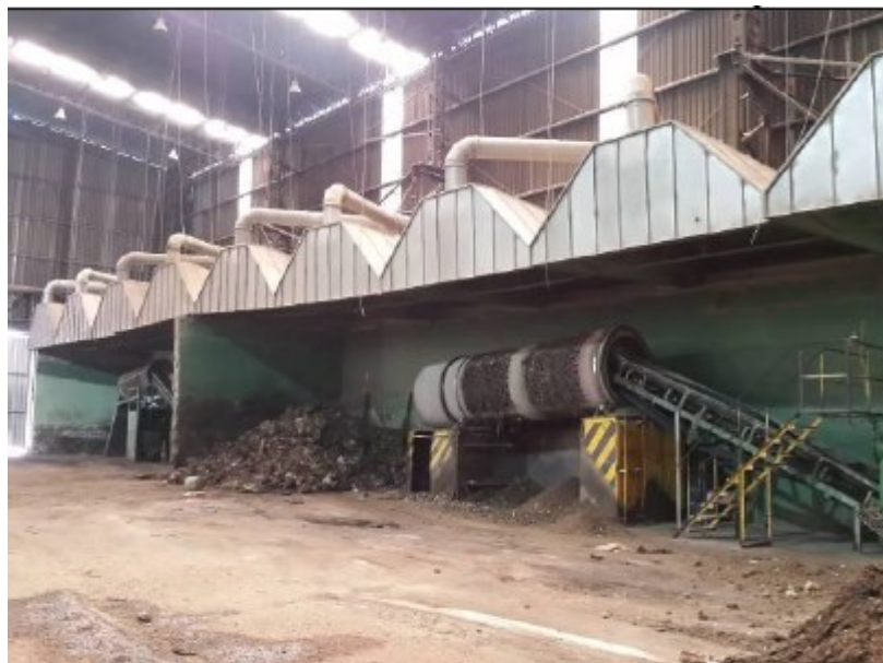
Figura 25: Peneiras rotativas acompanhadas de filtros exaustores
