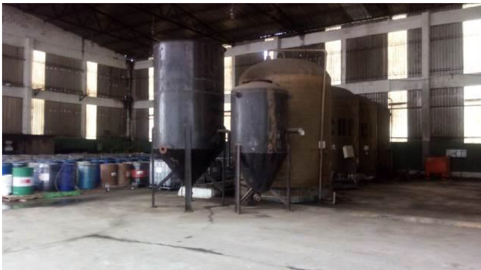
Figura 29: Filtração dos resíduos líquidos
