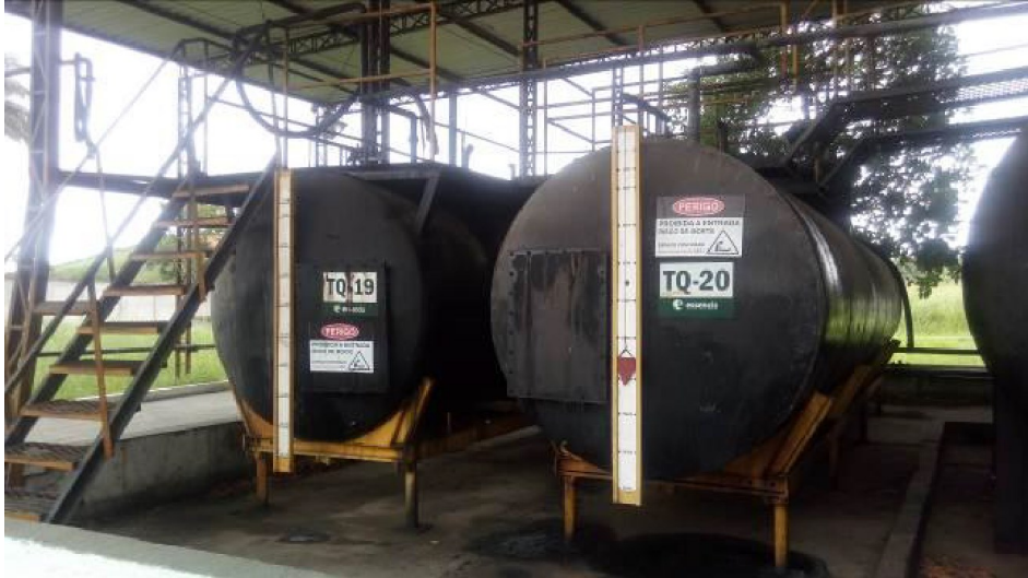
Figura 28: Tambores de Armazenagem de resíduos líquidos misturados
