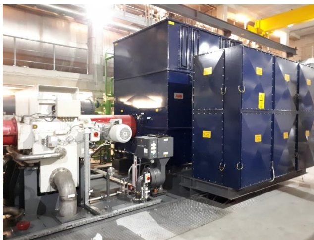
Figura 11: Fotos do gerador do incinerador TRIDEL.
