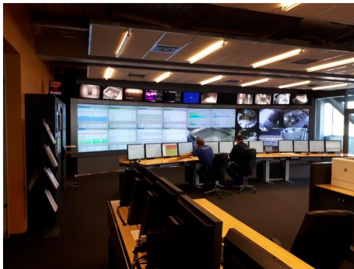
Figura 05: Sala de controle do incinerador de Genebra.
