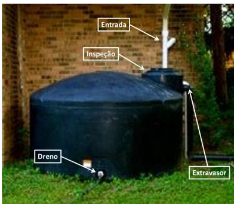
Figura 17 – Reservatório para captação de água da chuva.
