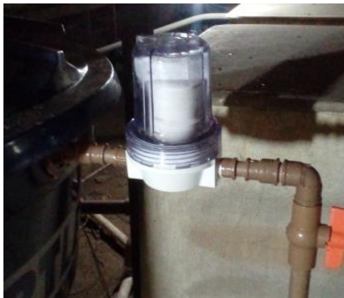
Figura 36 - Clorador automático utilizado no SAAP.
