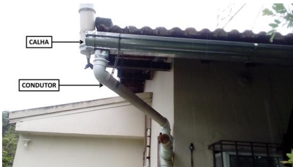
Figura 14 – Calhas e condutores em um sistema de aproveitamento de águas pluviais.
