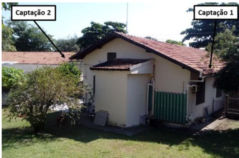
Figura 26 - Pontos de captação do sistema de aproveitamento de águas pluviais.
