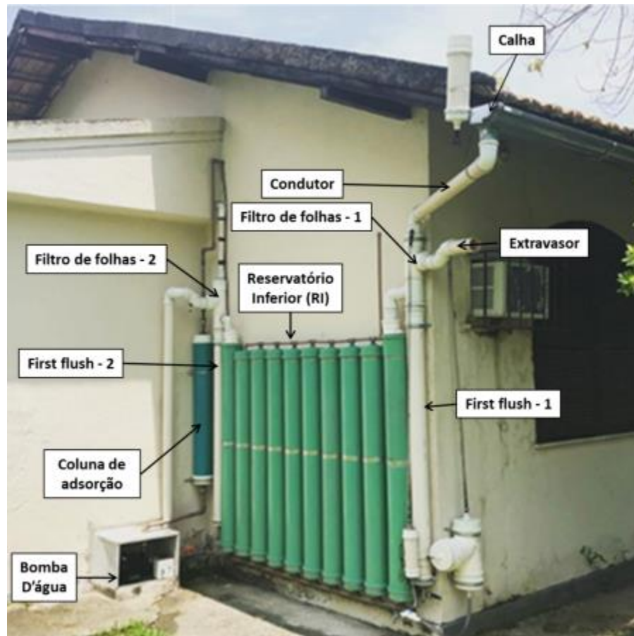
Figura 27 - Componentes envolvidos no tratamento da água da chuva localizados na parte externa do SAAP.
