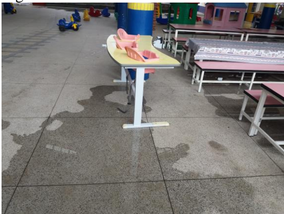
Figura 27- Refeitório no momento da chuva
