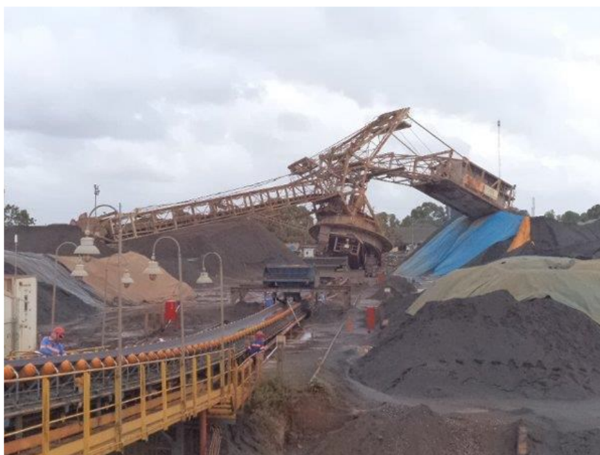
Figura 17 – Retomadora avariada ao fundo e pilhas de minério avançando próximas às margens do rio (UON, 2014)
