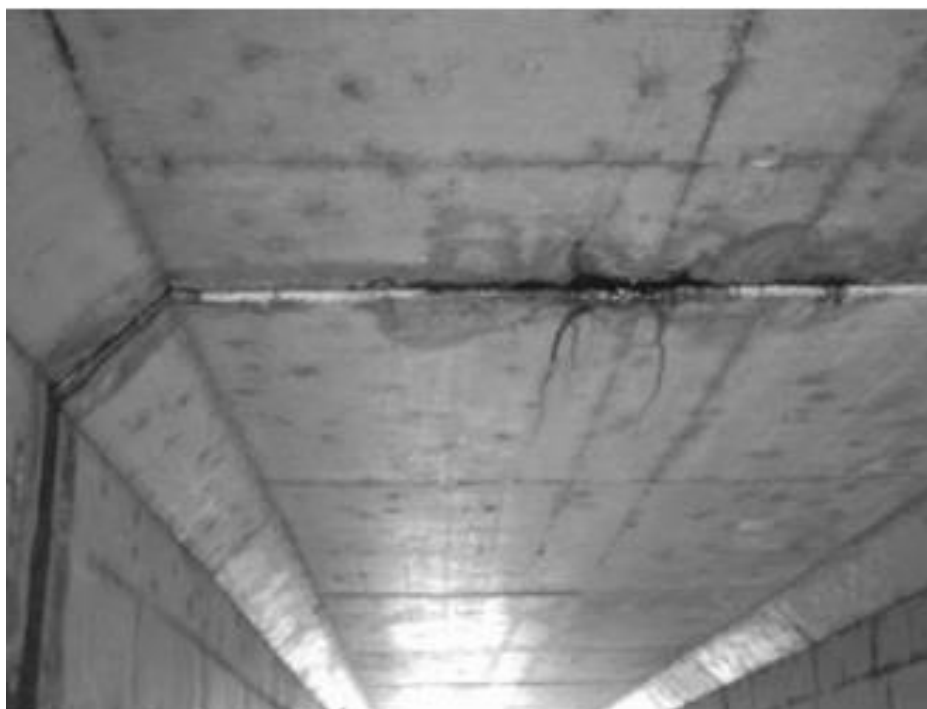
Figura 22:Segmento central do bueiro celular que sofreu recalque de 35mm (Vertematti & Montez, 2006)
