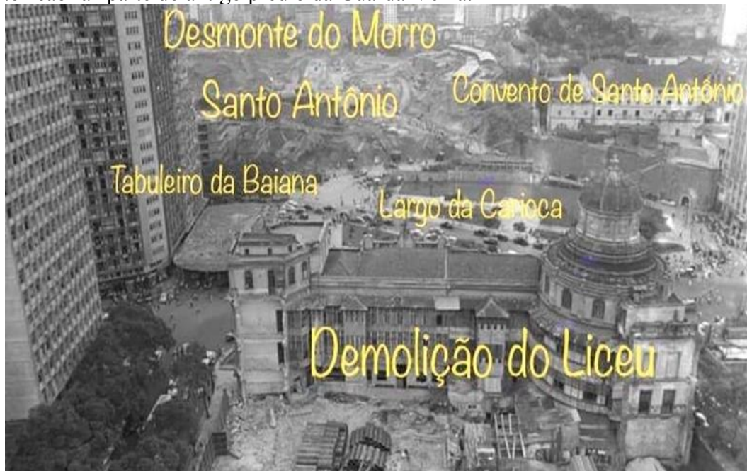
Figura 30 - Vista superior do Desmorte parcial do Morro de Santo Antônio e da demolição parcial do Liceu de Artes e Artes e Ofícios. A construção ao lado do torreão faz parte do antigo prédio da Guarda-Velha.
