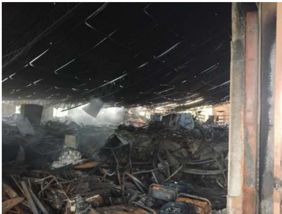
Figura 48 - Interior do CFCRSS após o incêndio de 2004
