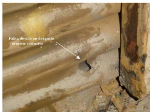
Figura 2: Falha devido ao desgaste erosivo-corrosivo de tubulação de parede d'agua de caldeira que opera a carvão. Fonte: ANEEL, 2007.
