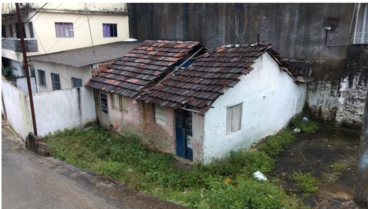
Imagem 11 - Casa precária, paredes de taipa e alvenaria
