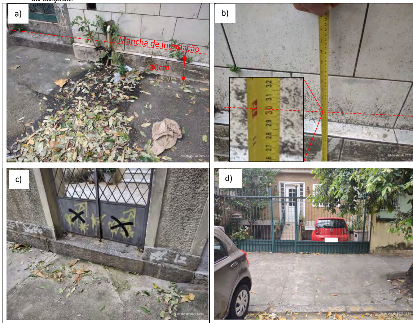
Figura 28 – Residência em frente ao PV 11 com a mancha de água na parede e casas com a soleira acima da calçada.
