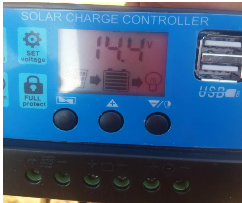
Figura 13 - Análise de funcionamento das placas pelo controlador de carga
