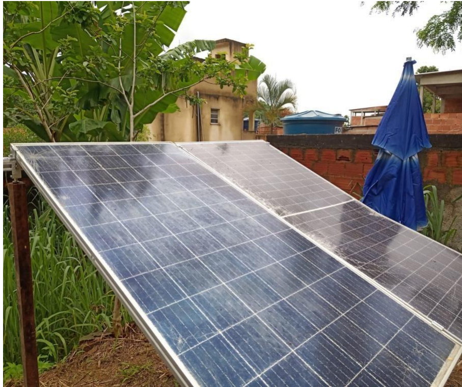
Figura 17 - Sistema Fotovoltaico instalado
