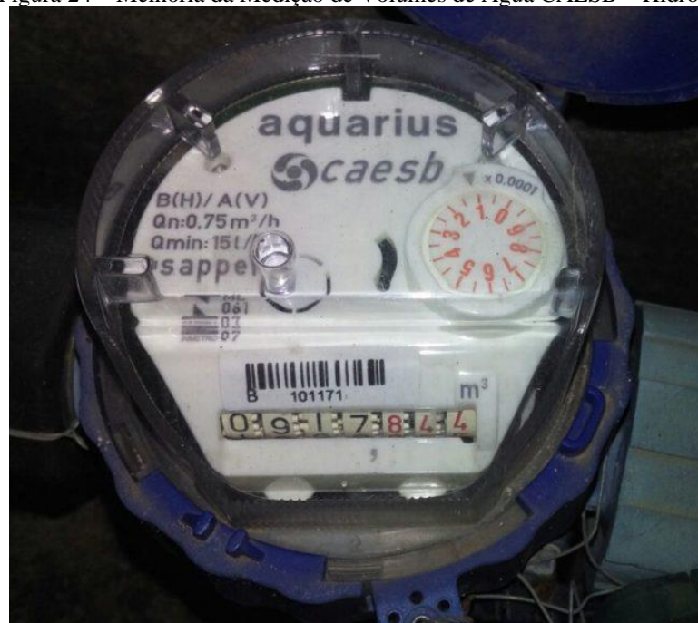
Figura 24 – Melhoria da Medição de Volumes de Água CAESB – Hidrômetro
