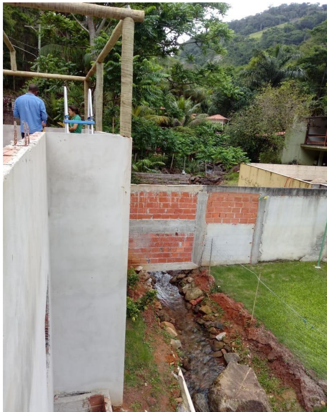
Figura 1 - Muro sobre riacho, apropriação de bem público.
