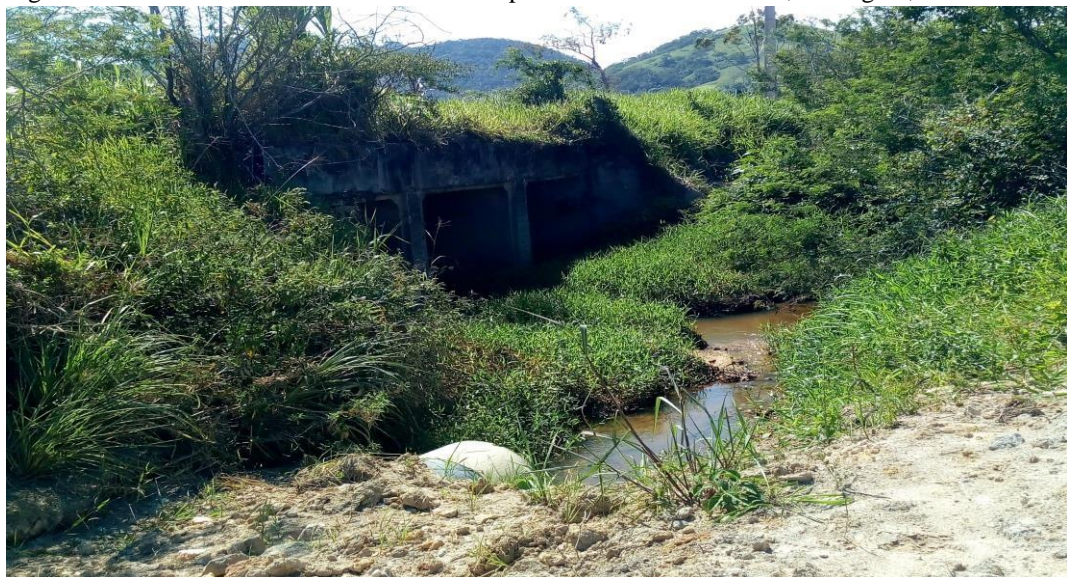
Figura 6 - Trecho do Rio Jundiá em acentuado processo de assoreamento, Cantagalo, Rio das Ostras.
