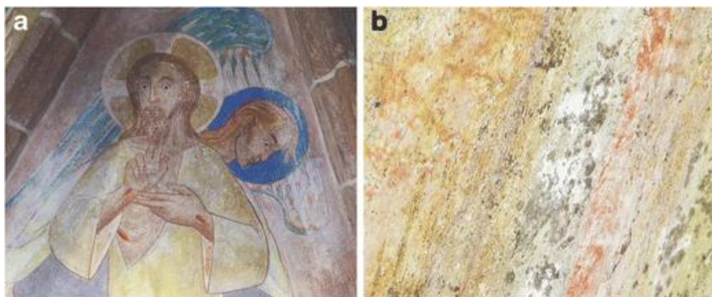
Figura 3 – Crescimento do fungo Cladosporium sp. (a e b) em uma pintura de parede moderna (Karl Weiser 1952, Weyregg, Austria)
