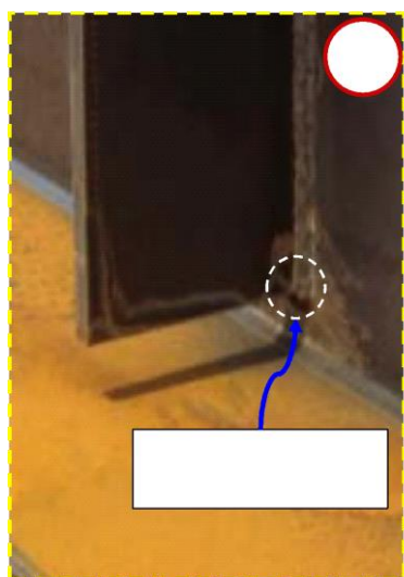
b.2) Detalhe da solda no enrijecedor intermediário com web-gap
