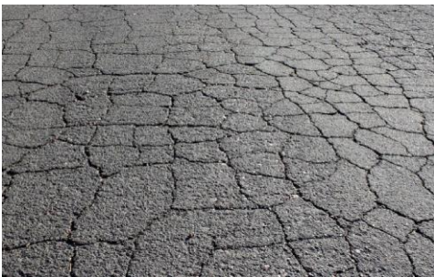
a) Fissuras decorrentes de fadiga
