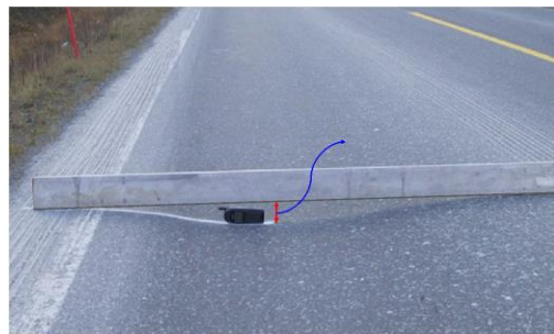
b) Afundamento em trilha de roda
