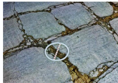
d) Trincas decorrentes da oxidação do ligante betuminoso
