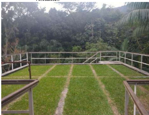
Figura 25 - Teto verde na entrada do museu do Boto-Cinza, localizado sobre o centro de visitantes
