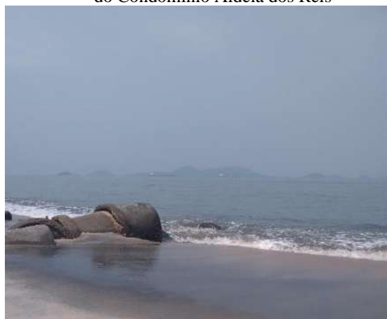
Figura 98 - Manilhas de esgoto desaguando na Praia do Sahy, cujo acesso foi possível fazendo uma pequena trilha no interior do Condomínio Aldeia dos Reis
