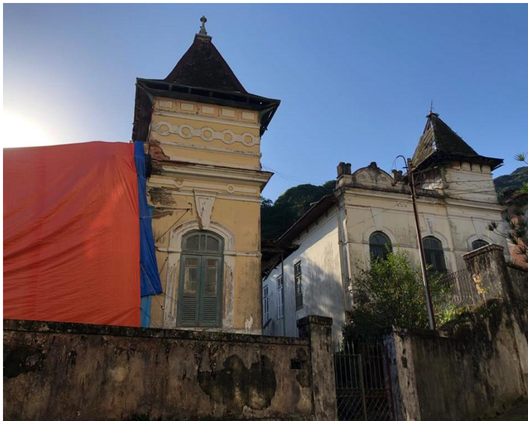
Foto 5 - Alto da Boa Vista: casas com aspecto de abandono
