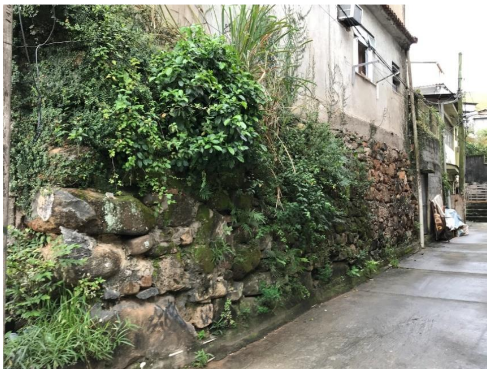
Foto 8 - Mata Machado: casa construída sob fundações de antiga construção
