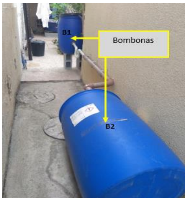
Figura 36 – Bombonas plásticas utilizadas no processo de tratamento de água cinza
