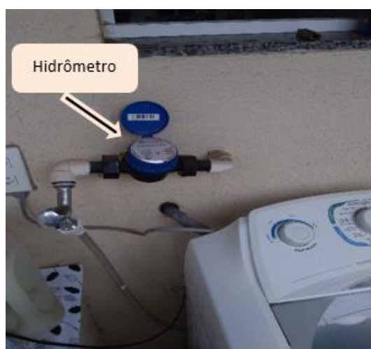
Figura 33 – Hidrômetro (HID-MLR) para registrar o volume de água utilizada por acionamento da máquina de lavar roupas
