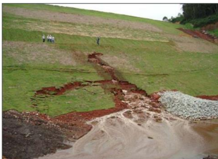
Figura 55. Piping em 2009 (Morgenstern et al. , 2016).
