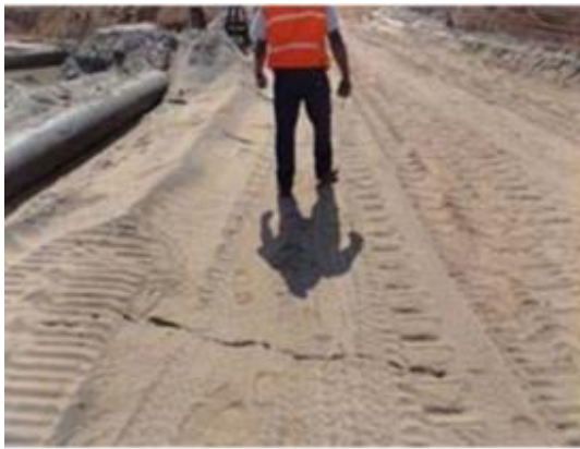
(b) trincas na crista
