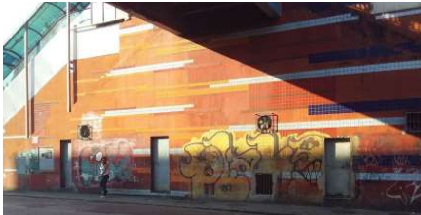
Figura 29 - Grafites e pichações nas paredes da estação Estação do Méier
