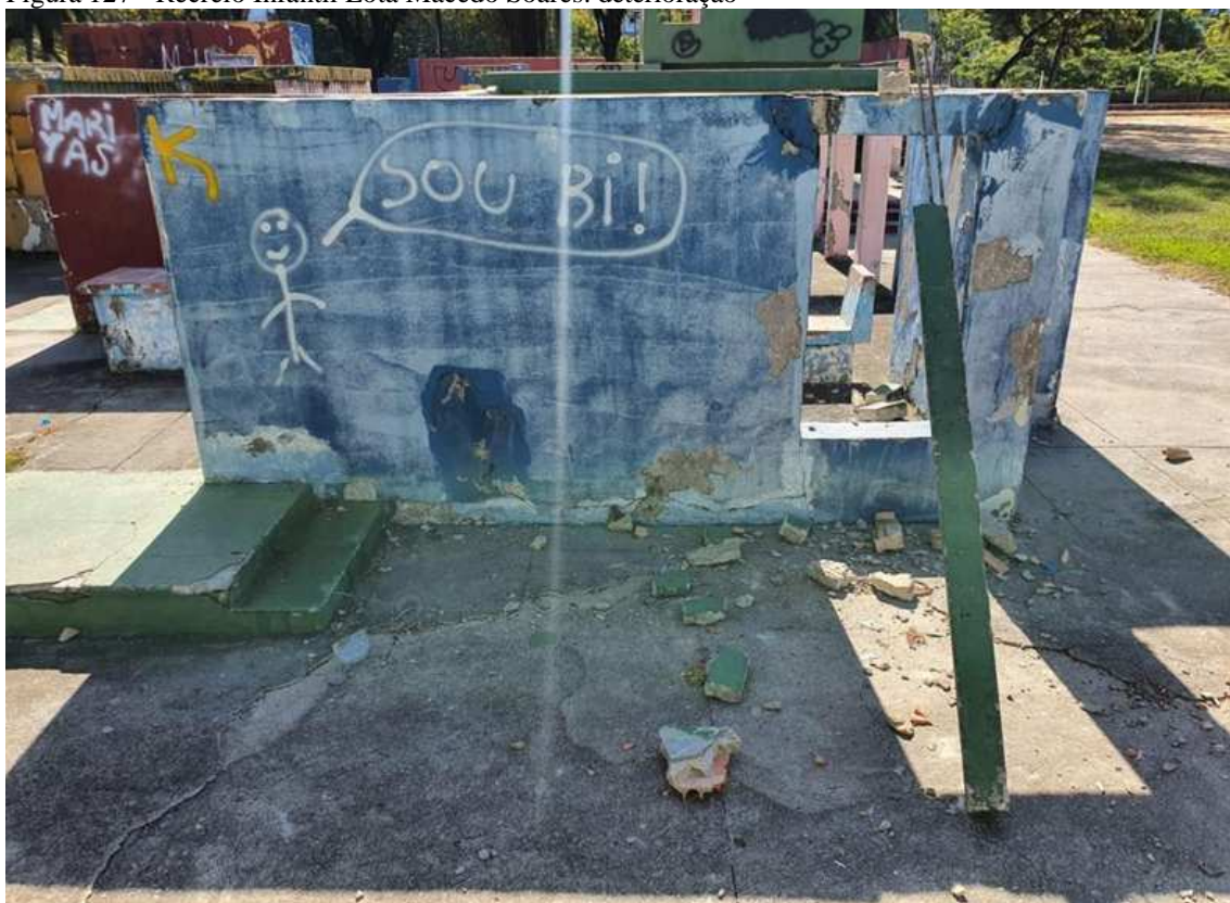
Figura 127 - Recreio Infantil Lota Macedo Soares: deterioração
