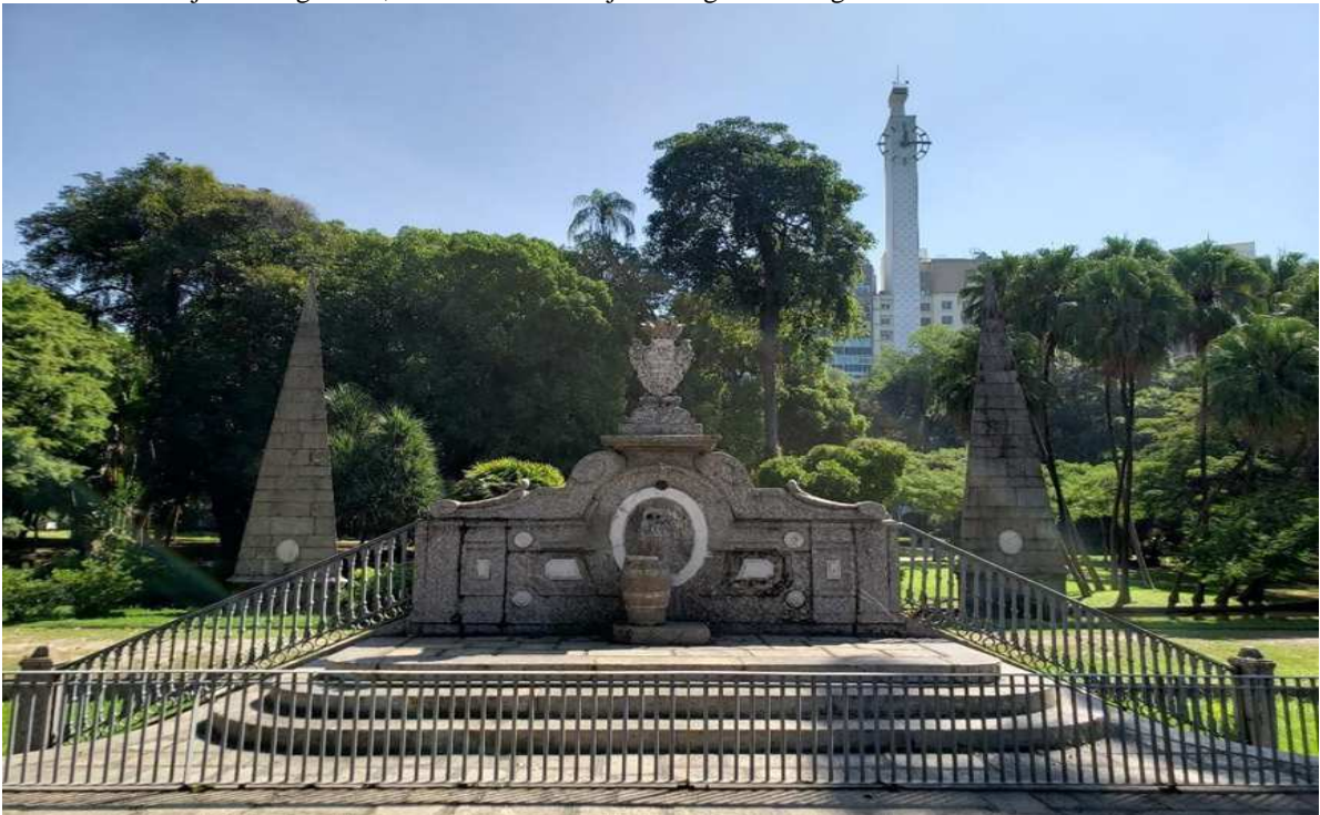
Figura 20 - Fonte do Menino (sem a estátua que lhe deu o nome), com as pirâmides ao fundo. A situação desse conjunto de gnaiss, bronze e lioz é hoje de flagrante indigência
