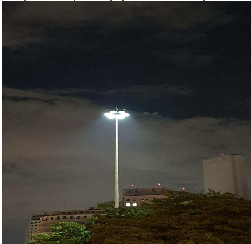
122 Figura -. Iluminação do Parque posicionada acima da copa das árvores.
