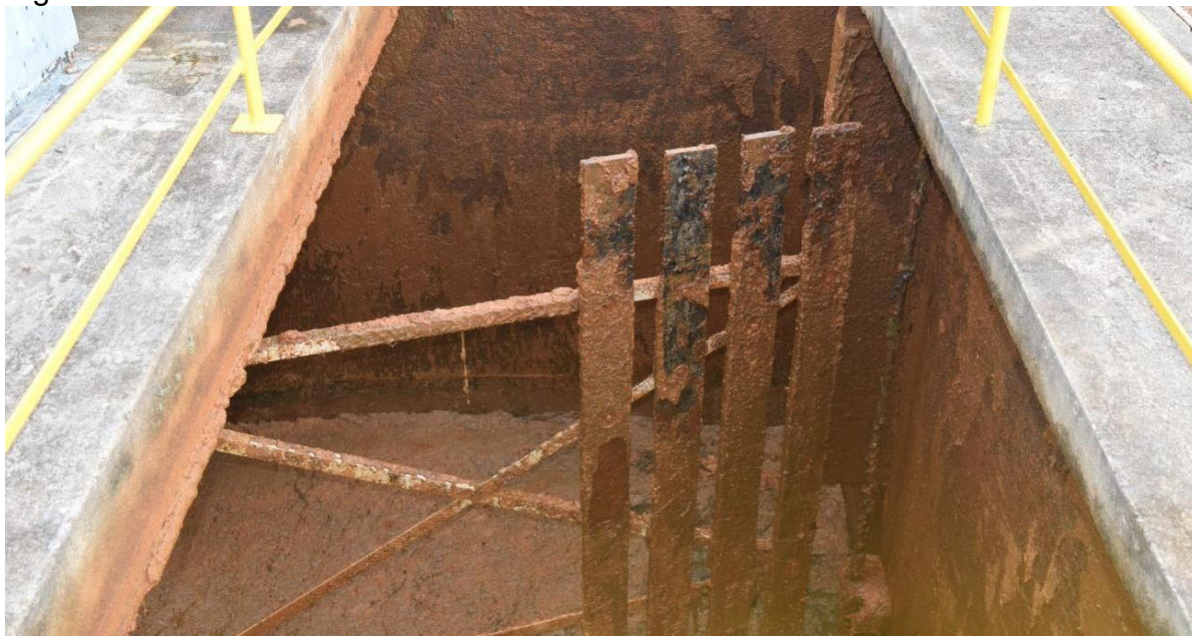
Figura 2 - Flocos aderidos nos floculadores de uma ETA.
