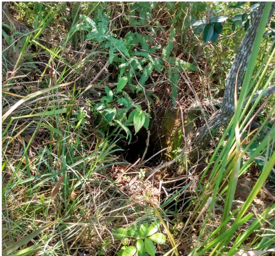
Figura 5 - Pipe inlet na área de estudo
