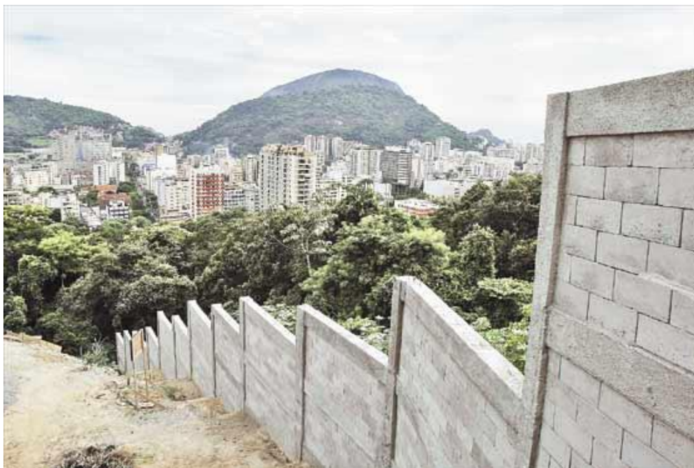
Fotografia 2 – Muro construído na favela Santa Marta-RJ, em 2008
