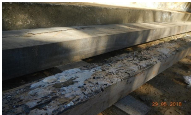
Figura 27 - Madeira danificada pelo gusano.
